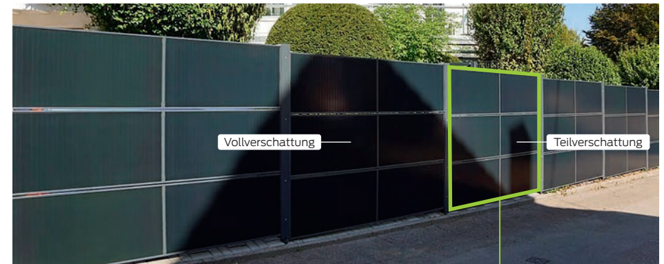
Top: Beim Solarzaun arbeiten auf einer Fläche von 4,5 m 2 6 parallel verschaltete Photovoltaik-Module.
